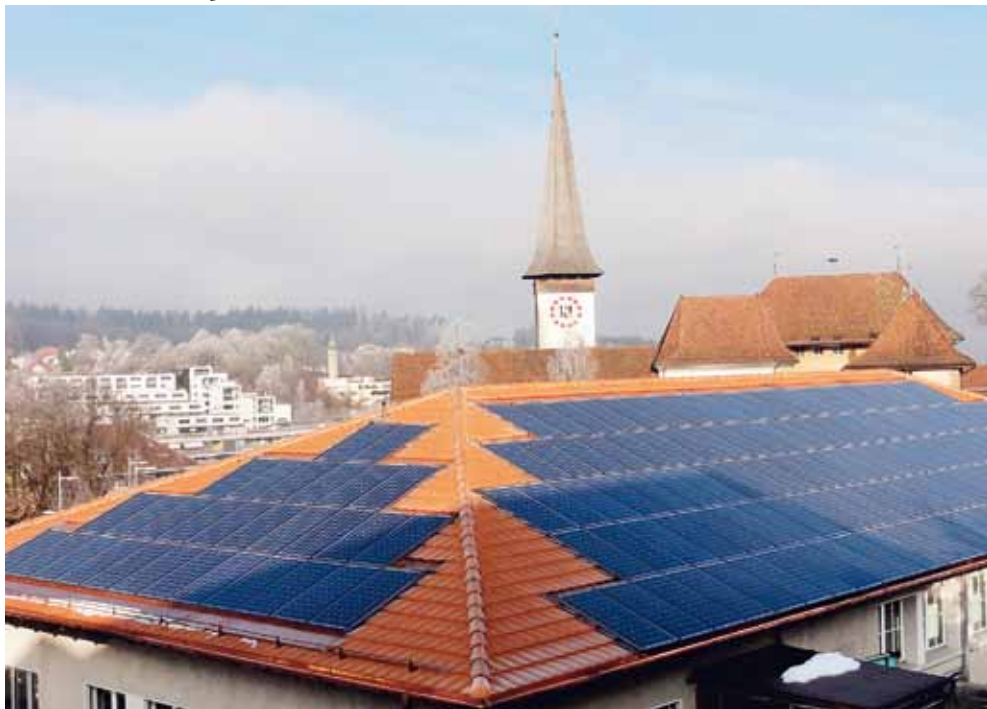
Energiestadt Köniz: Photovoltaikanlage auf der Turnhalle des Oberstufenzentrums Köniz
