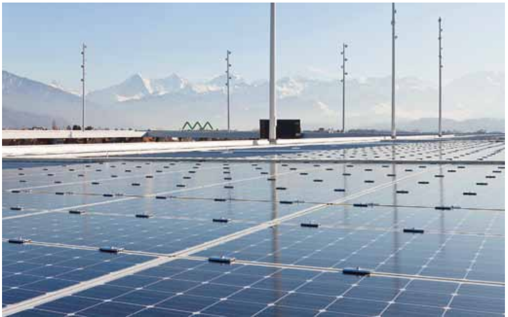
Die Anlage auf dem Stadionsdach liefert jährlich Strom für 90 Haushalte.
